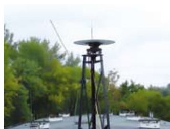
Stacja WAT1. Antena odbiorcza GPS
