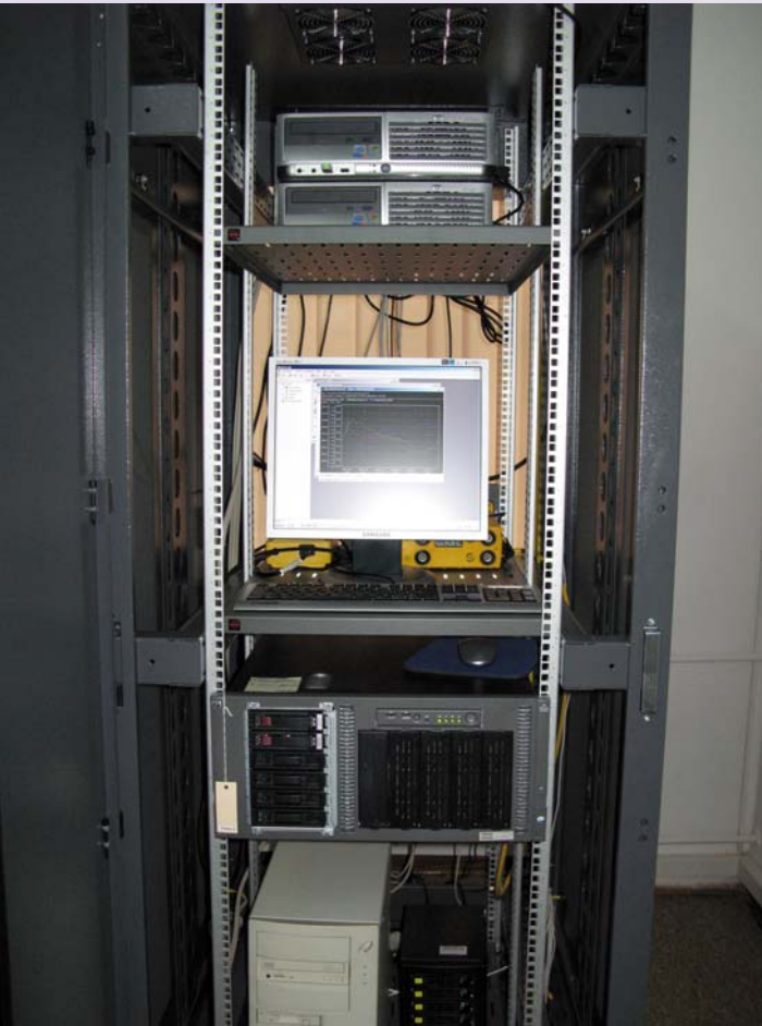
Fot. 2. System zarządzania stacją referencyjną i pomiarami meteorologicznymi
