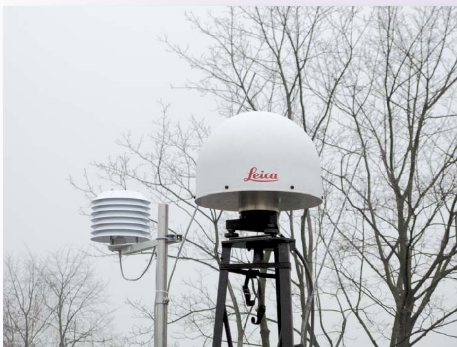
Fot. 1. Stacja referencyjna GNSS WAT1. Na pierwszym planie antena GPS/GLONAS, na drugim – głowica meteorologiczna
