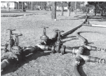
Rurociąg polowy o średnicy 150mm.
