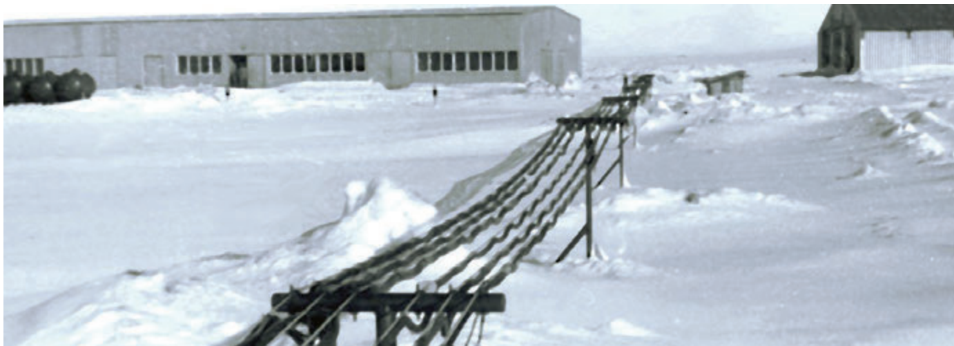
Pierwsze zimowanie. Kable energetyczne zasilające stację
