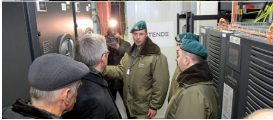
Zaletą Kontenerowego Centrum Przetwarzania danych jest możliwość jego niemal błyskawicznego przystosowania do potrzeb użytkownika
